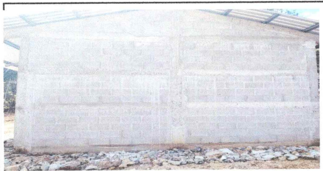
Foto 3: se observa la falta de tallado de las columnas y soleras del modulo 2
