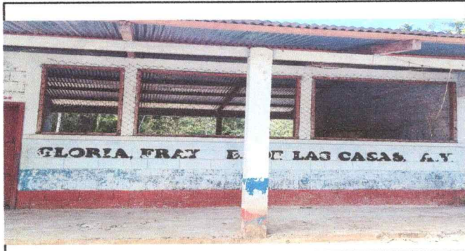
Foto 1: se observa el deterioro del color del muro, la estructura y la ventanería del modulo 1
