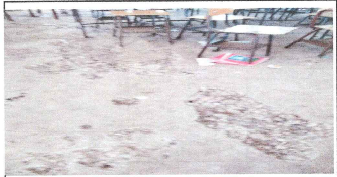
Foto 4: se observa el mal estado del piso del modulo 3
